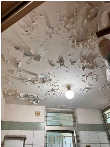
廚房天花翻新前
