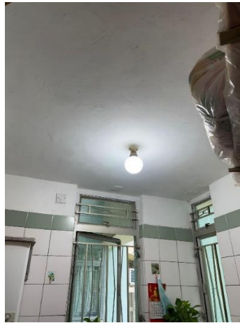
廚房天花翻新前
